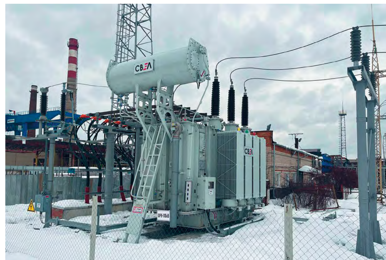
ПС 110 кВ «Электролитная», Челябинская обл., ТРДН-40 000/110 УХЛ1
