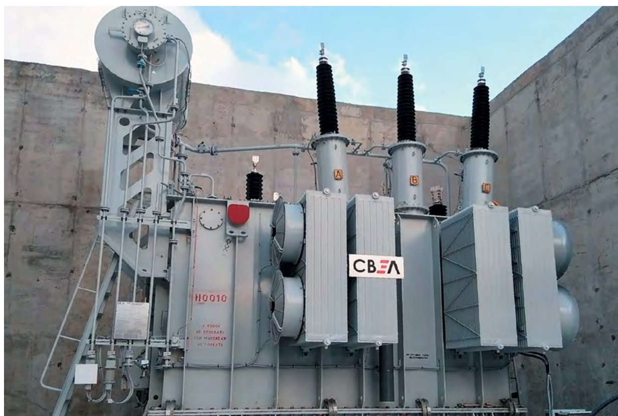
ПС 110 кВ «Северово», г. Подольск, ТДТН-63 000/110 У1
