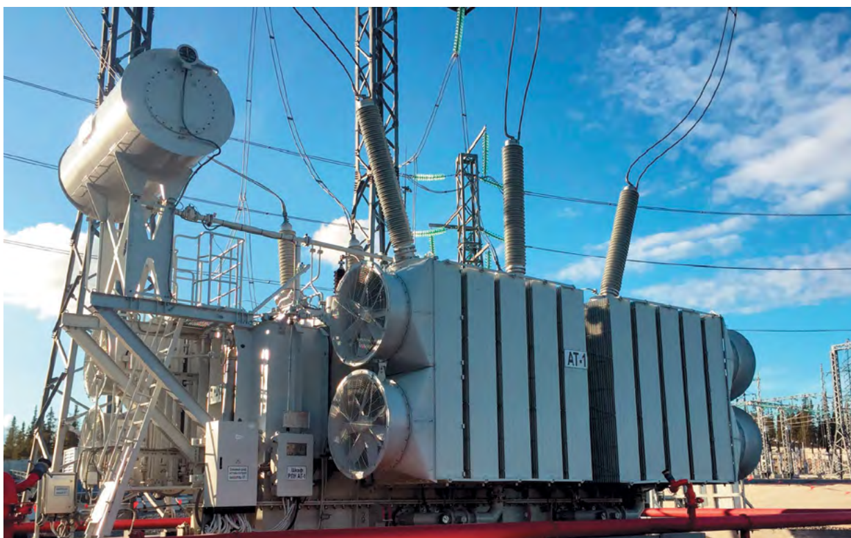
ПС 330 кВ «Мурманская», г. Мурманск, АДЦТН-250 000/330/150 УХЛ1
