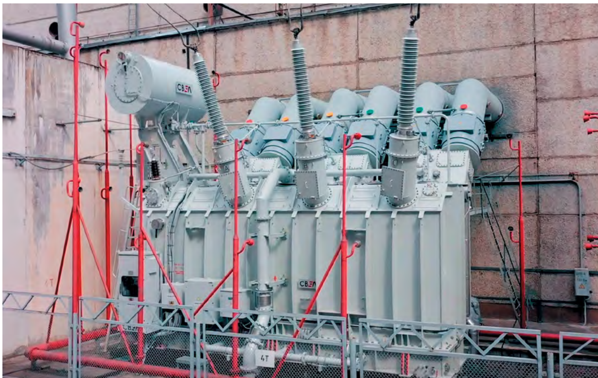
Красноярская ГЭС, г. Дивногорск, ТЦ-630 000/220 ВМ УХЛ1
