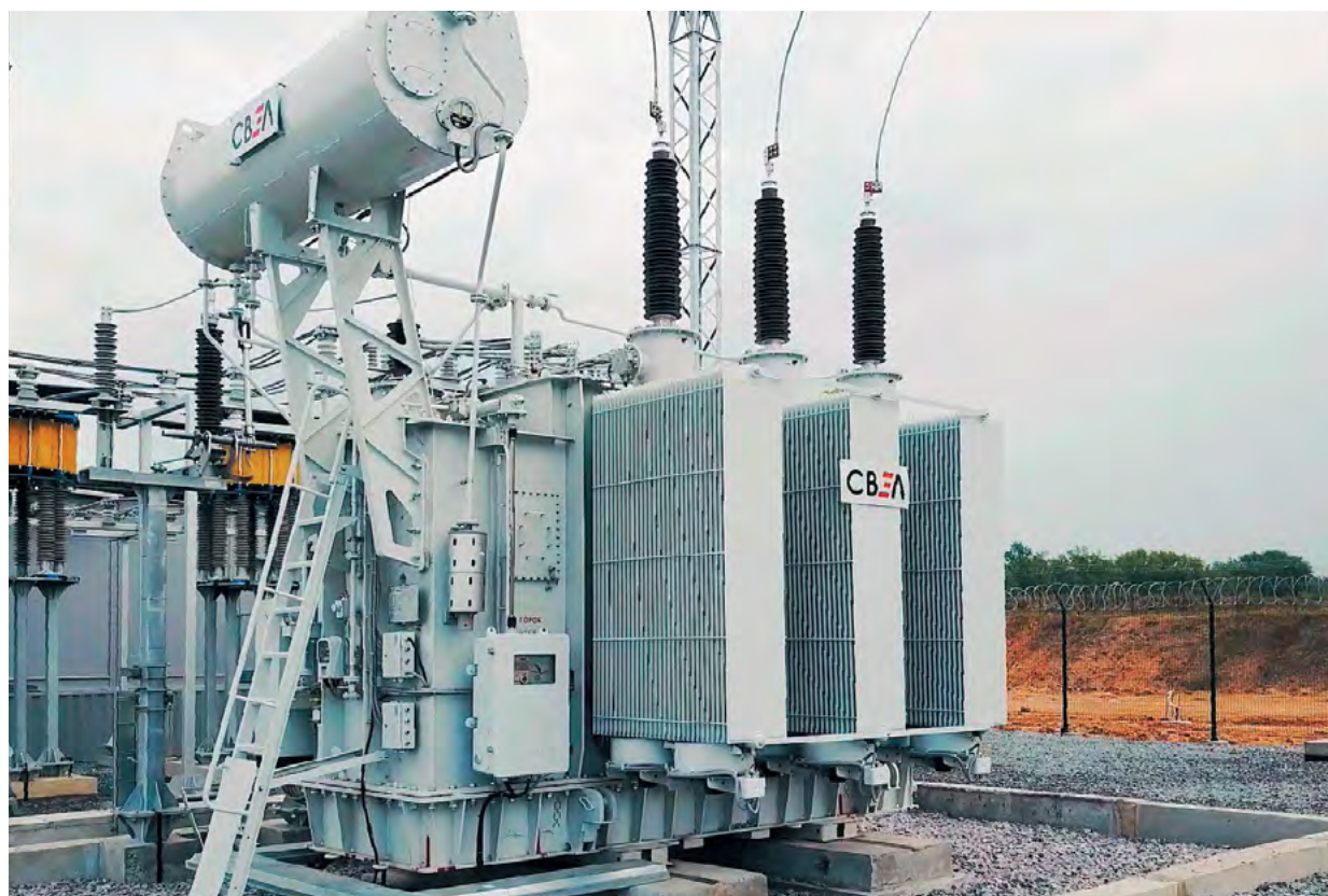
ПС 110 кВ «Гринхаус», Белгородская область, ТРДН-63 000/110 УХЛ1
