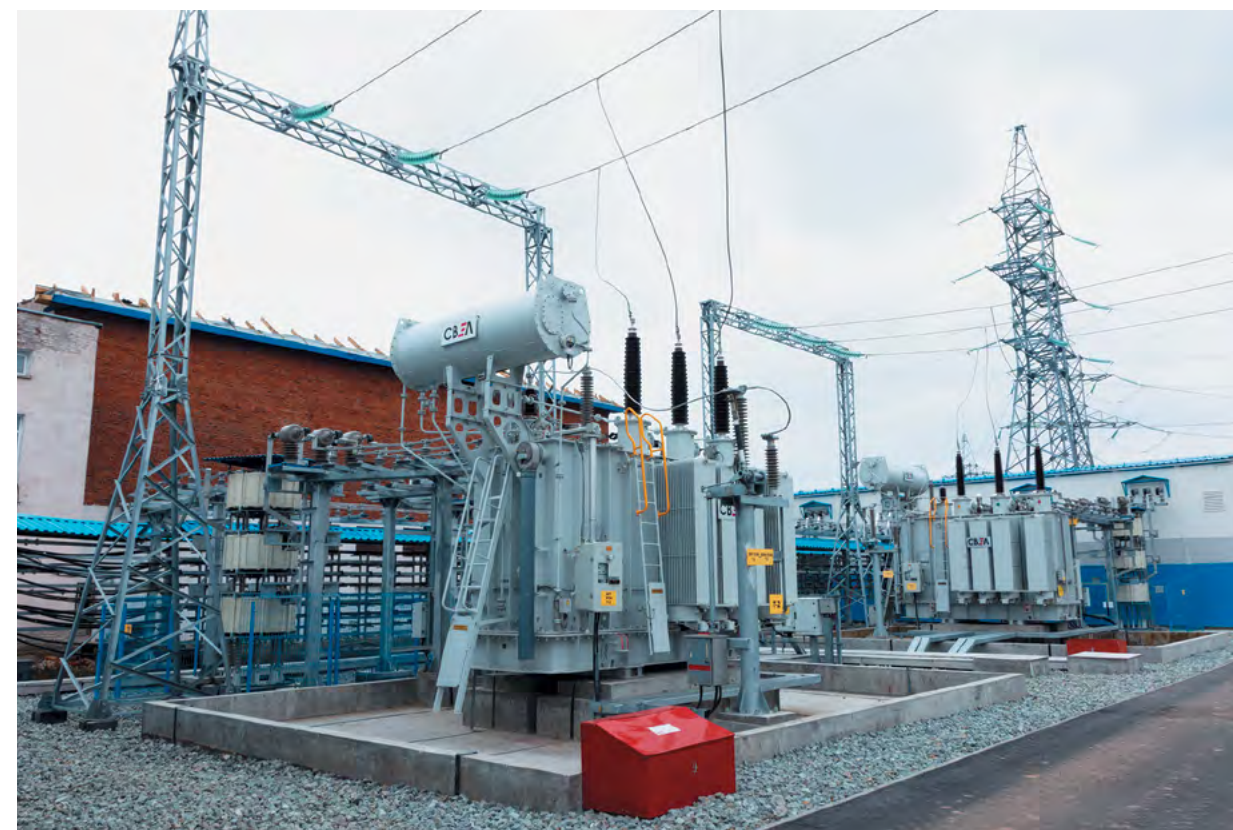
ПС 220 кВ «Зеленодольская», респ. Татарстан, ТРДН-40 000/110 УХЛ1
